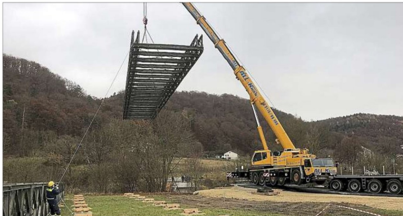
Alleine das Grundgerüst der Bailey-Brücke wiegt etwa 27 Tonnen und wurde mit einem Autokran über die Altmühl gehoben.
