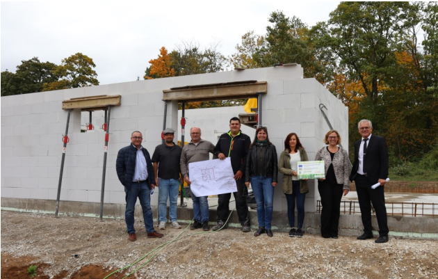
Baustellenbesichtigung: Bürgermeister Ludwig Eisenreich (rechts) mit Vertretern der Stadtverwaltung, des Tourismusbüros, von Altmühl-Jura und ausführenden Firmen (Foto: Platzek/Berching)
